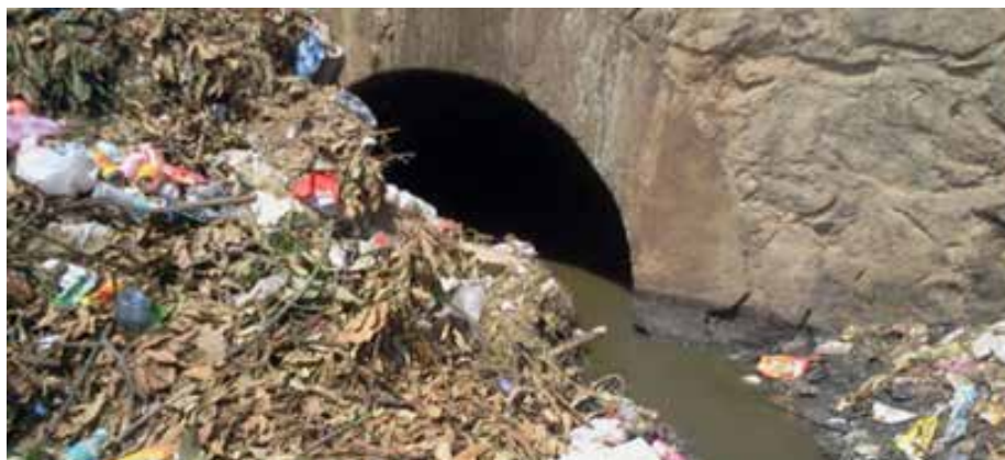
Figura: 6 – Descarga de águas residuais no rio Caculuvar (figura 38).
