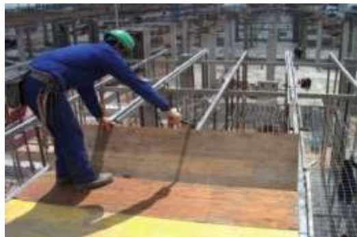
Figura 3. Obrero en la construcción del Parque Tecnológico de la universidad “Oscar Lucero Moya” de Holguín
